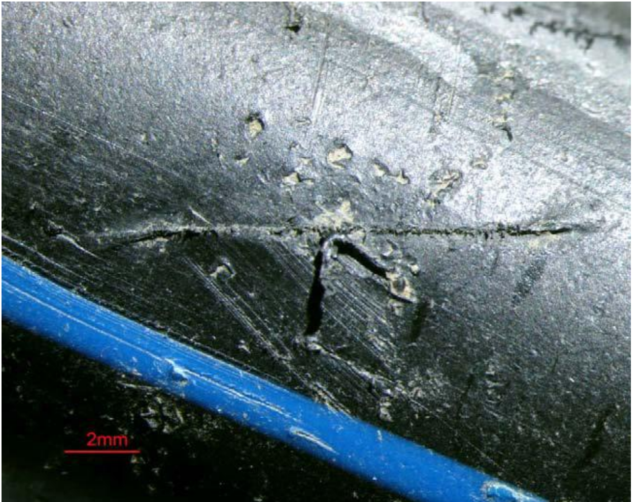
Снимок 34. Поврежденный участок. Деформация наружной поверхности. Гамильтон, Огайо.
