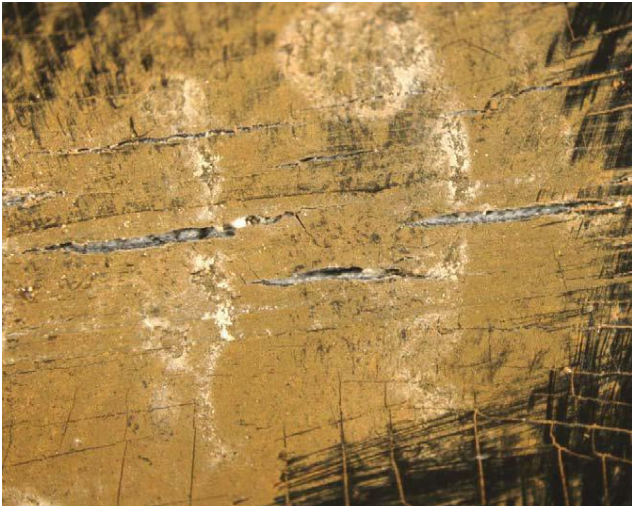
Снимок 5. Частичное разрушение с обратной стороны места утечки.
