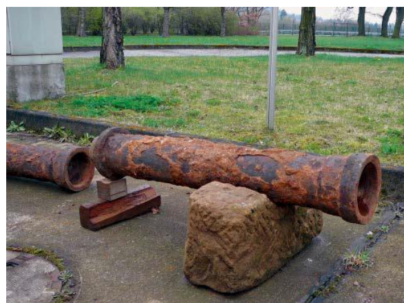
Рис. 9 Труба, извлеченная в месте Weiseritz
